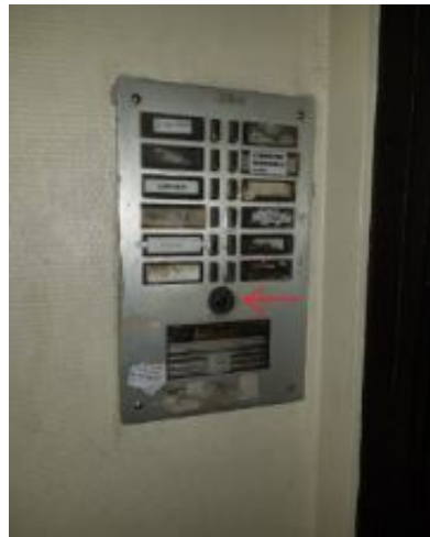
Use one of the 2 keys to open the door/ Utiliser une des 2 clés pour ouvrir la porte
