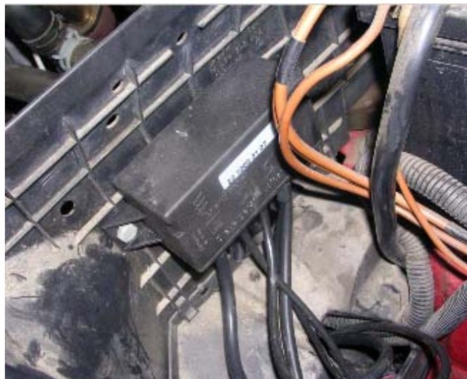
Photo 22 Fixation de l'unité de control
