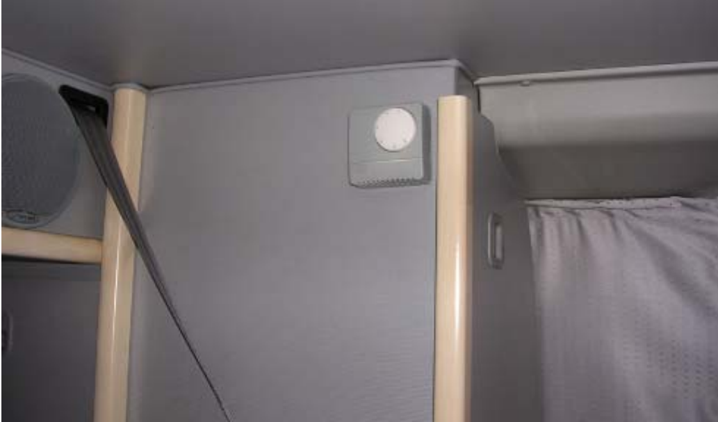
Photo 33 : Emplacement du thermostat.
